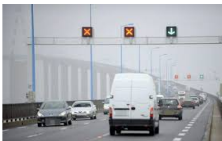
FIGURE 1 – Signalisation de voies dynamiques sur le pont de Saint-Nazaire en France. Crédit photo : Inconnu. Photo extraite du site : http://www.pau-circulation.fr/2010/09/innovatio-high-tech-du-pont-de-saint-nazaire/
