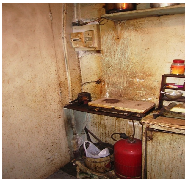
Loger des « mal logés » est un droit de l'homme
