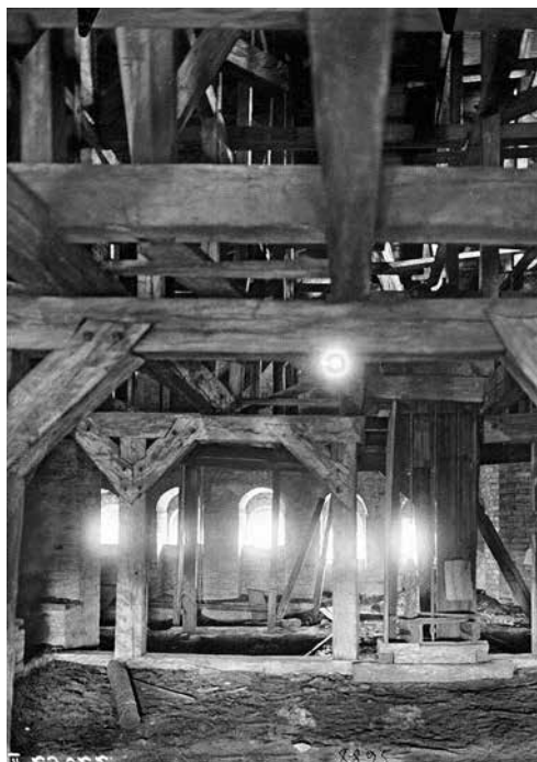
Деревянные конструкции чердака Благовещенской церкви Супрасльского монастыря. Фото И. Ф. Чистякова, 1908 г. (?) (ФО. Нег. II 29622)
