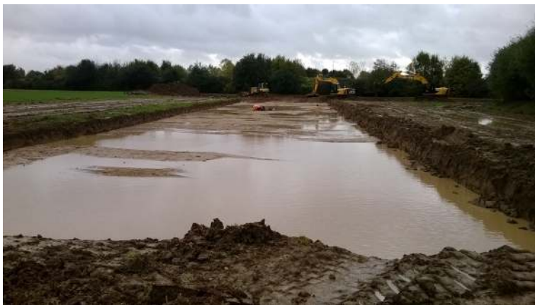
Fig. 7 – Vue générale de la partie sud de l'emprise en cours de décapage. Cliché : V. Brunet © Éveha 2013.
